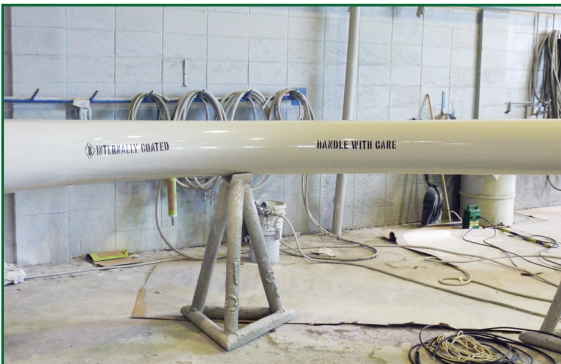
Novocoat SC2200 Rapid Set Pipe Coating aplicado en el exterior. Novocoat SC3300 Novolac Epoxy Lining aplicada en el interior.
